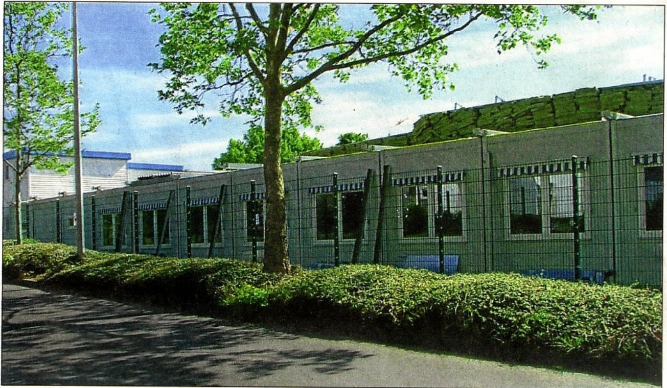
Die Abbauarbeiten am F-Trakt sind im Gange. Bis Ende Mai sollen die Container endgültig verschwinden.
